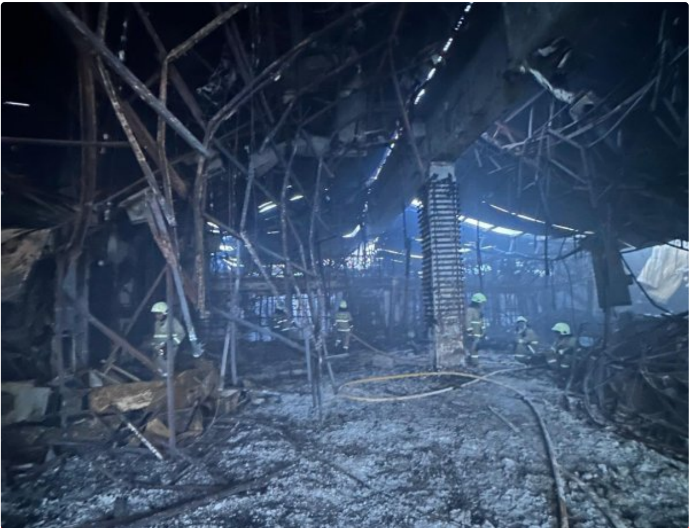
Glodok Plaza yang Hangus Terbakar
